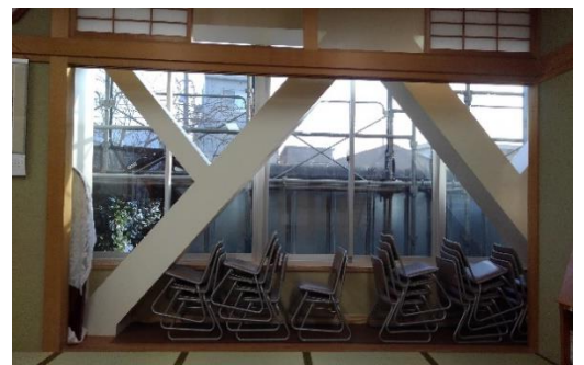
和室南側の窓に設置された耐震用の筋交い
